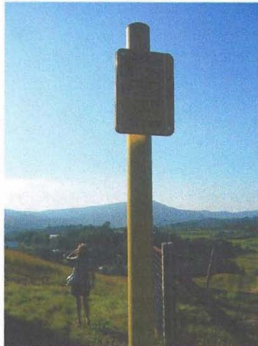
Sinalização do gasoduto ( a Poente da parcela)
